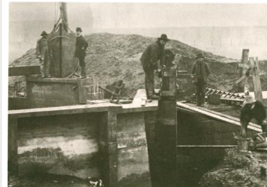
45 Die Auslaufkammer der Vorkläranlage wurde mit Muskelkraft betoniert. Bauführer und Polier überwachten die Tätigkeit – Arbeitsschutz war so gut wie unbekannt.
