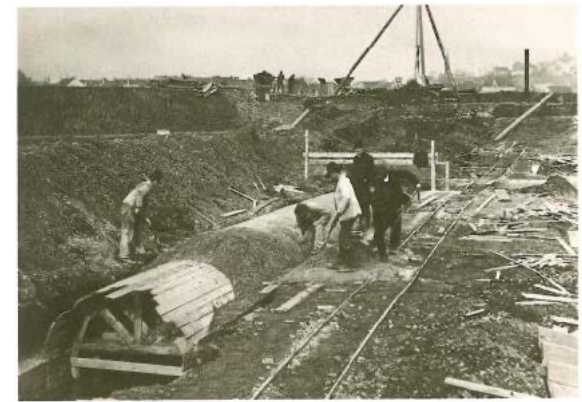
46 Die Rohwasserleitung zum Filterbecken wurde genau geschickt und vor Ort betoniert. Nachdem der Beton abgebunden hatte, löste man die Kelle der inneren Stützrihre und versetzte die Schalung weiter nach vorn.
